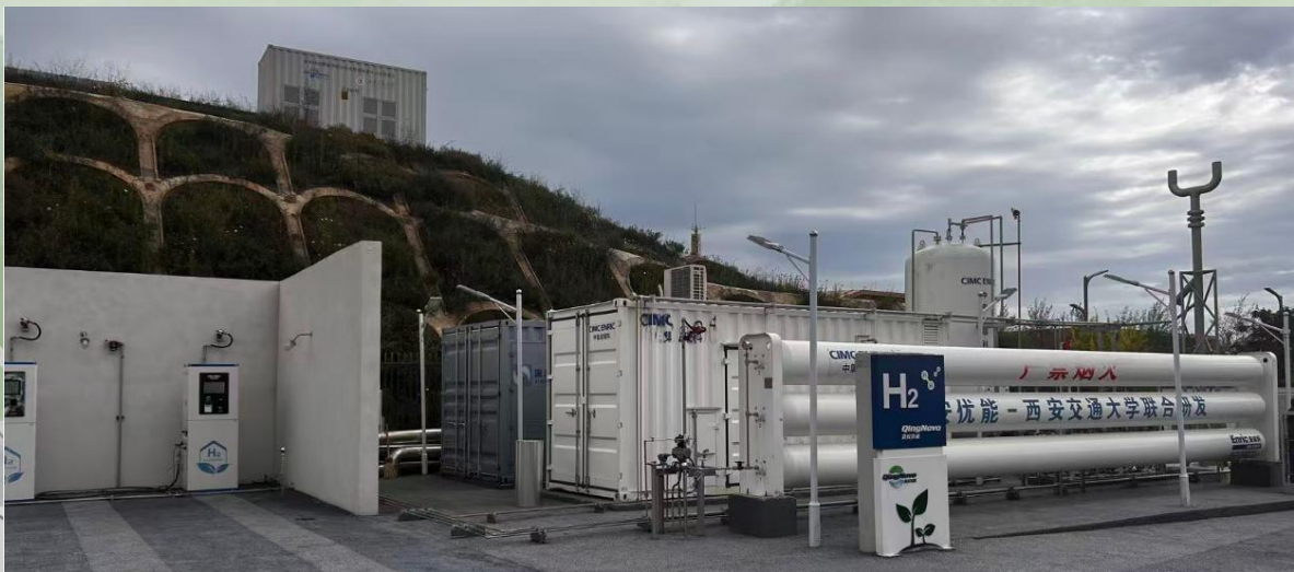
上图为榆林运动员村科创园区氢能绿色能源设施
